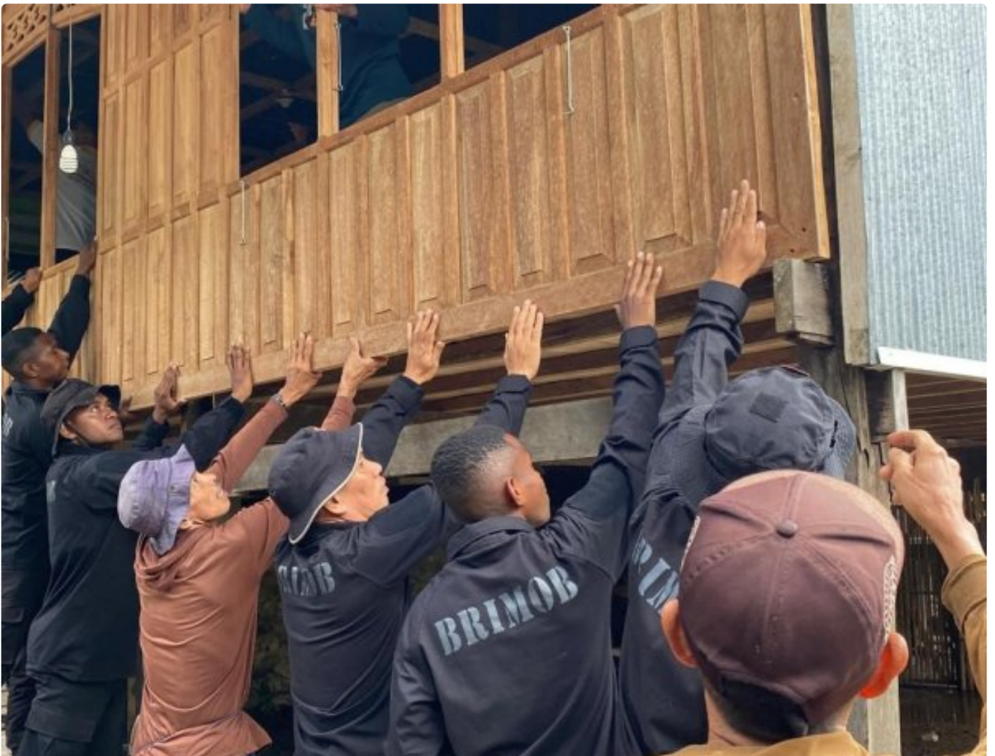
Tim SAR Brimob Sulsel Bantu Pembongkaran Rumah Warga Terdampak Longsor di Soppeng
